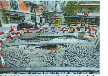
En haut de la rue Marterey, les poches d'eau ont soulevé des pavés, créant d'énormes trous. CHRISTIAN BUN
